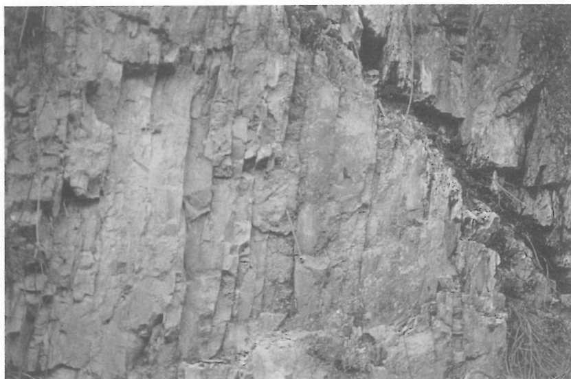
Fig. 5 - Aspetto tipico della litofacies marno-siltosa; evidente il clivaggio di frattura subverticale ben regolato. L'immagine si riferisce alle Marne del T. Pignone affioranti lungo la Val Pignone (Cinque Terre).
